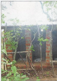
Die Toilettenanlage verbessert die hygienischen Bedingungen.
